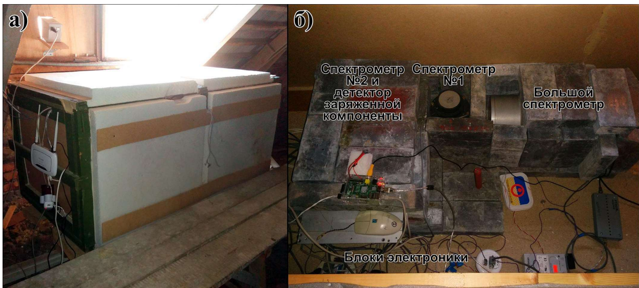
Рис.1.27. а) Внешний вид контейнера с приборами, б) Внутреннее расположение приборов в контейнере
