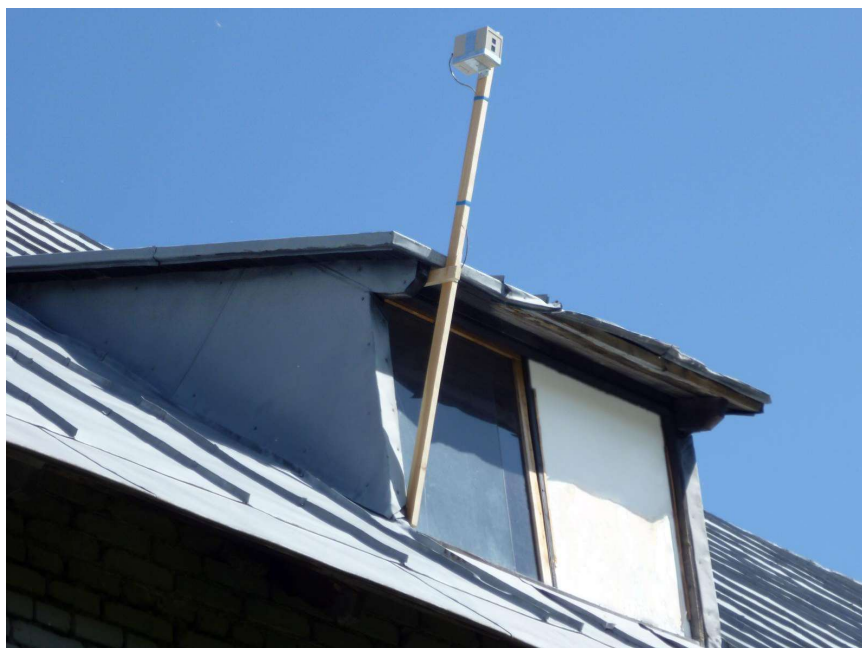
Рис. 1.24. Внешний вид установленного датчика осадков.
